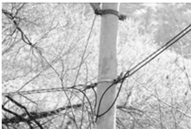
Gambar 3.5 Kabel ADSS yang ditambatkan pada Tiang Listrik
