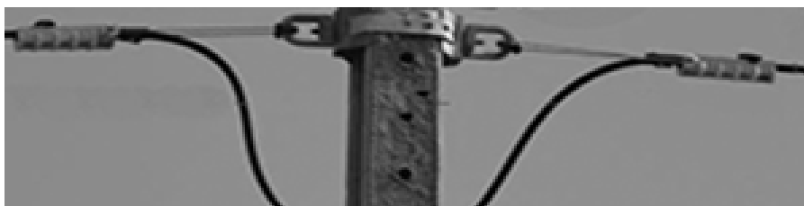
Gambar 3.7 Penambatan ADSS pada tiang
